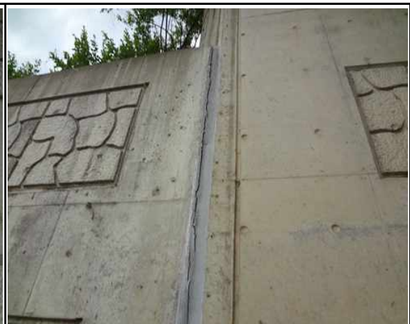
상동IC방향 A2 실란트 파손
