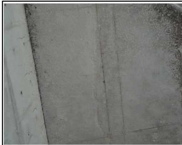
상동IC방향 S1 균열 (폭0.2mm)
