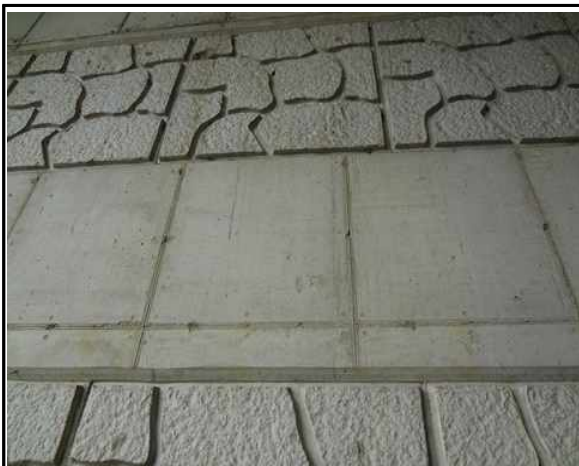
군도8호선방향 A1 균열 (폭0.2mm)
